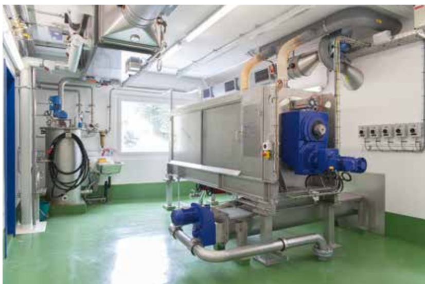
Foto oben: Rechenanlage
