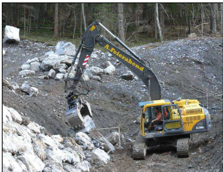
Setzung der Blocksteine beim Ablenkdammm.
